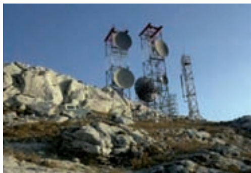
Radioenlaces y antenas de televisión de las islas Baleares. Este centro entró en servicio en mayo de 1964 emitiendo en el canal 6. Estaba situado en Sierra Alfabia, en uno de los puntos más elevados de la isla de Mallorca, a 1.016 metros de altura, y sustituyó al primitivo reemisor de Puig Mayor, que posteriormente fue desmontado.
