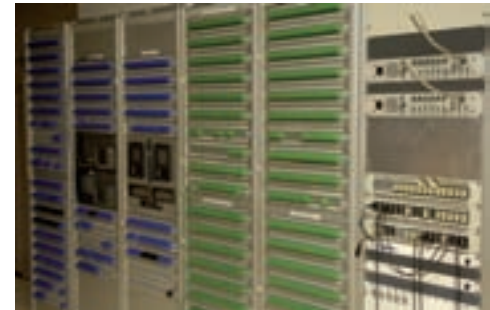
Sistemas de comunicaciones del sistema central de control de informativos de TVE. En la imagen se pueden apreciar algunas clavijas que conectan diferentes emplazamientos. Fuente: TVE.
