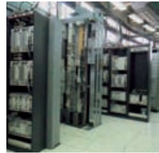
Armarios de la red fija de radioenlaces emplazados en la corona interior de la planta 5ª de Retevisión (hoy Abertis Telecom) en la torre de Collserola.
