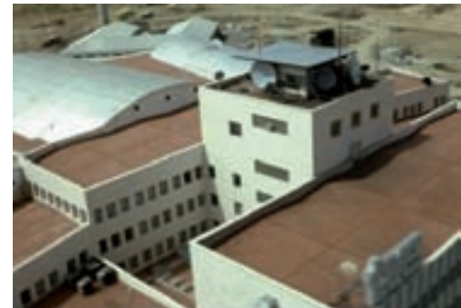
Equipos de televisión Española situados en la azotea del edificio de Prado del Rey. Cuando entró en funcionamiento Torrespaña, en 1982, se centralizaron los equipos de enlaces fijos, que hasta entonces estaban distribuidos entre Prado del Rey y Paseo de la Habana.
