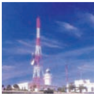
Antena de televisión en el cabo de San Antonio. En la imagen se puede ver el radiofaro en la parte posterior y las infraestructuras de transporte y difusión de la señal.
