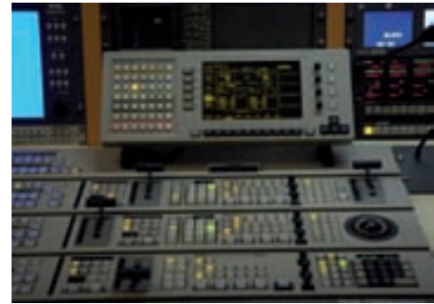
Sistemas de Control utilizados en TVE. Fuente: TVE.
