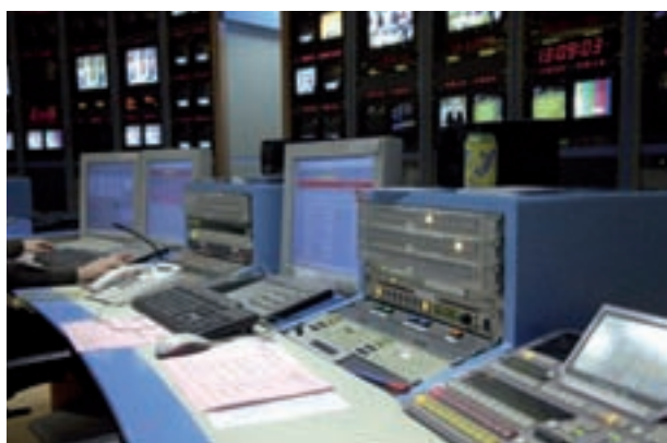
Control de continuidad de TVE. Fuente TVE.
