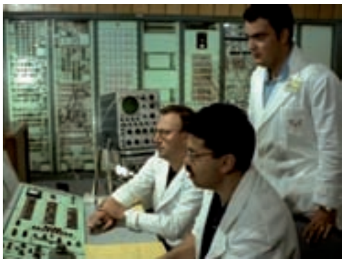
Sala de control desde donde se gestionan todas las emisiones que se realizan. Al fondo se pueden ver los equipos de comunicaciones utilizados, que constituyen un punto fundamental de la televisión.
