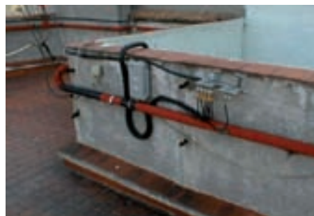
Detalle de un punto de distribución o TAP en la red coaxial de distribución.
