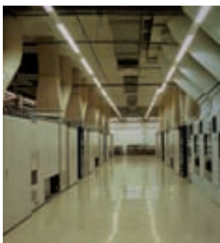
Sala de emisión de Retevisión en Collserola; en ella conviven los transmisores de la televisión analógica con los de la digital. En la misma sala, aunque no aparecen en la fotografía, se encuentran múltiples emisoras de radio.
