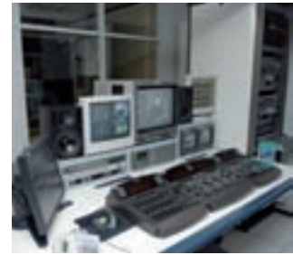
Unidad Cambio De Formato TVE sistema DAVINCI. Fuente:TVE.
