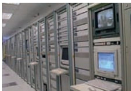
Cabecera de consolidación de una red de cable actual.
