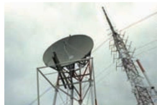
Equipamiento típico de transmisiones de televisión: antenas y radioenlaces.
